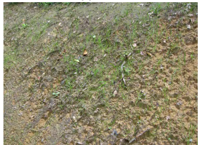
Abbildung 5: Ausreichende Pflanzenanzahl/Fläche, jedoch noch keine ausreichende Bodendeckung für eine Abnahme.
