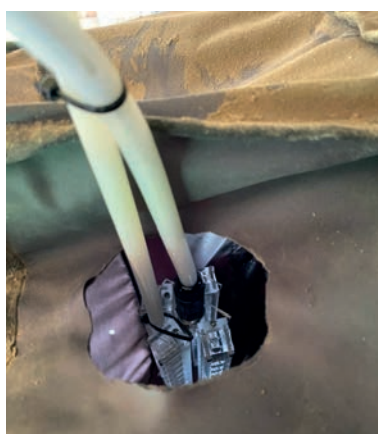
Abbildung 4 und 5: Einbau des Ionisators in den vet.smart.tube (© Neumayer, 2022)
