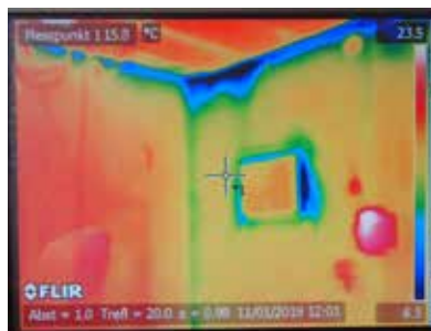
Abbildung 5: Undichtigkeiten im Bauwerk
