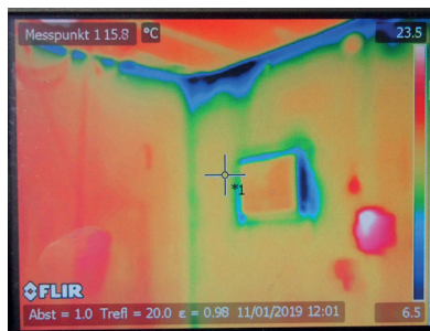
Abbildung 5: Undichtigkeiten im Bauwerk
