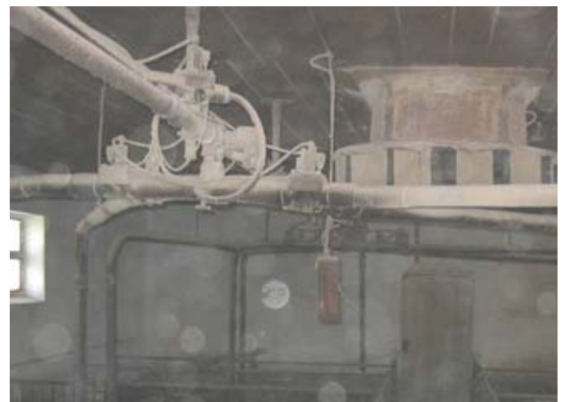
Abbildung 3: Zentrale Strahl Lüftungseinheit mit 360° Öffnungen
