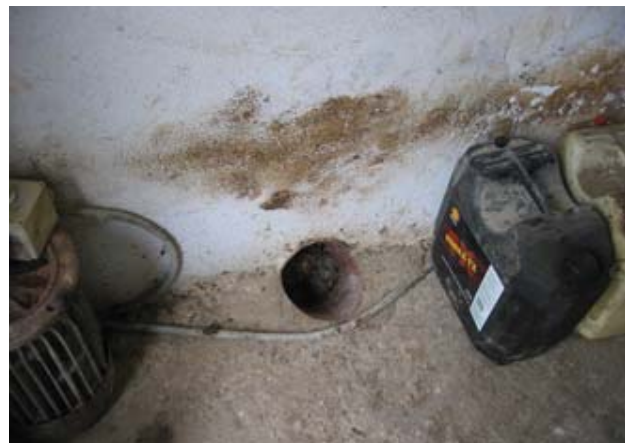
Abbildung 19: Direkter Falschlufteintrag in das Abteil
