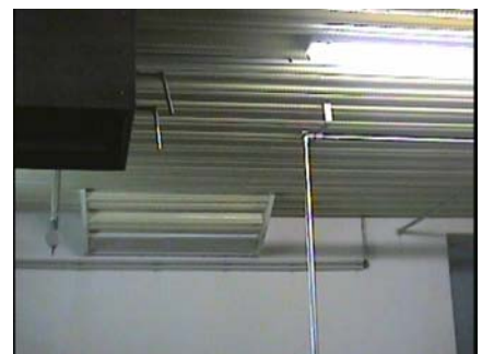
Abbildung 7: Digitales Tageslichtbild von Zuluftseinheit
