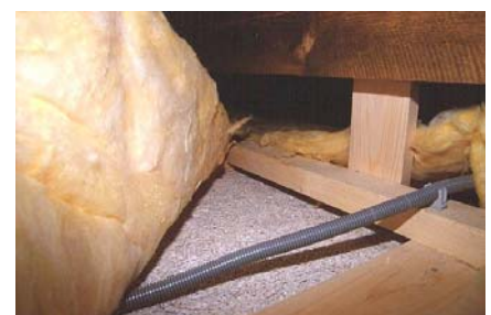
Abbildung 1: Dämmung nach Elektroinstallation nicht wieder hergestellt
