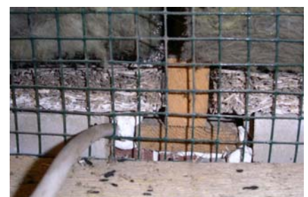
Abbildung 2: T-Träger nicht ordnungsgemäß ausgeführt
