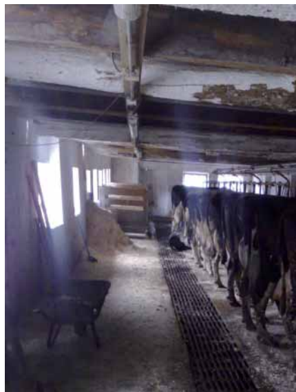
Abbildung 4: Im Kopfbereich werden, durch zu geringe Raumhöhe, die vorgeschriebenen Werte nicht erreicht
