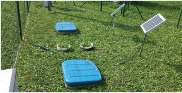
Abbildung 2: NITRATMO-Messsysteme installiert am Standort Wagna (Aufnahme vom 18.9.2014).
