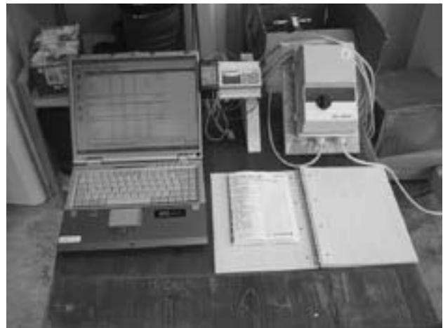
Abbildung 4: Steuerung Ziehl-Abegg FF 091
