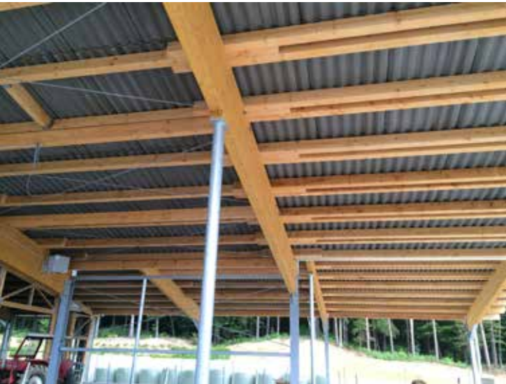
Billige Dachkonstruktionen bringen Probleme Foto: E. Zentner
