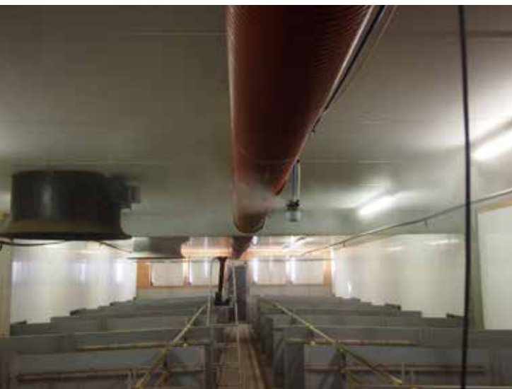
Kühlung der Stallluft durch Zweistoffdüsentchnik
