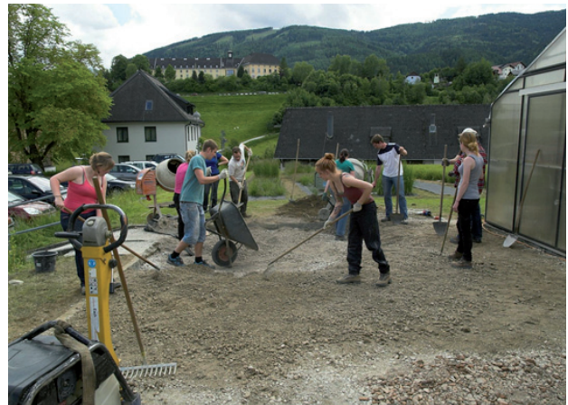
Abbildung 13: Einbau der Vegetationstragschicht durch Studenten der Universität für Bodenkultur (Mai 2013, Foto Aeberli)
