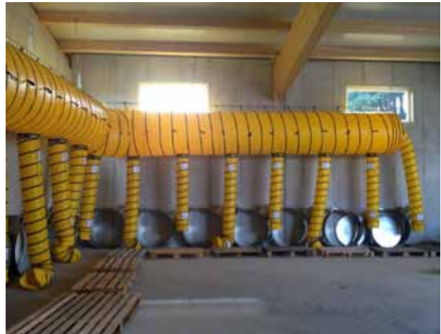
Bild 6: Rundballenbelüftung mit flexiblen Schläuchen (Foto: LASCO)
