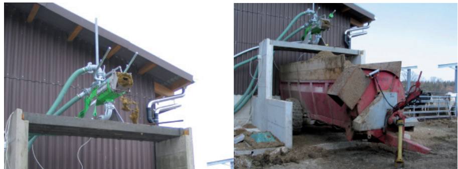
Abbildung 2: Die Rohgülle wird mit einer Siebschnecke (Pressschnecke) separiert (links) und mit einem Kompoststreuer eingestreut (rechts).
