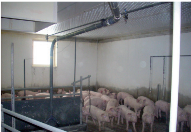
Abbildung 1: Zuluftdecke in einem Mastabteil (gelochte Hartschaumplatte)
