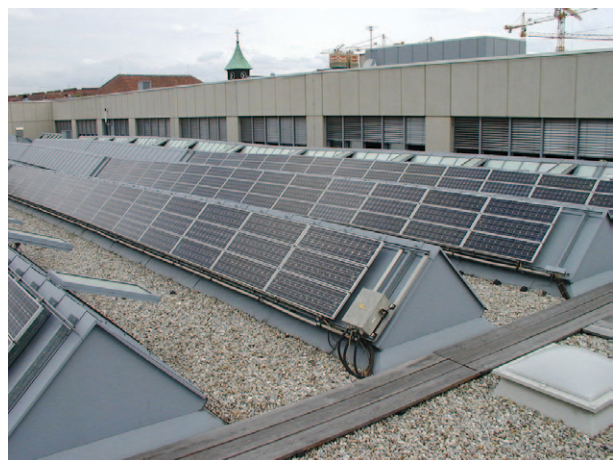
11) Photovoltaikanlage HTL Wien X
