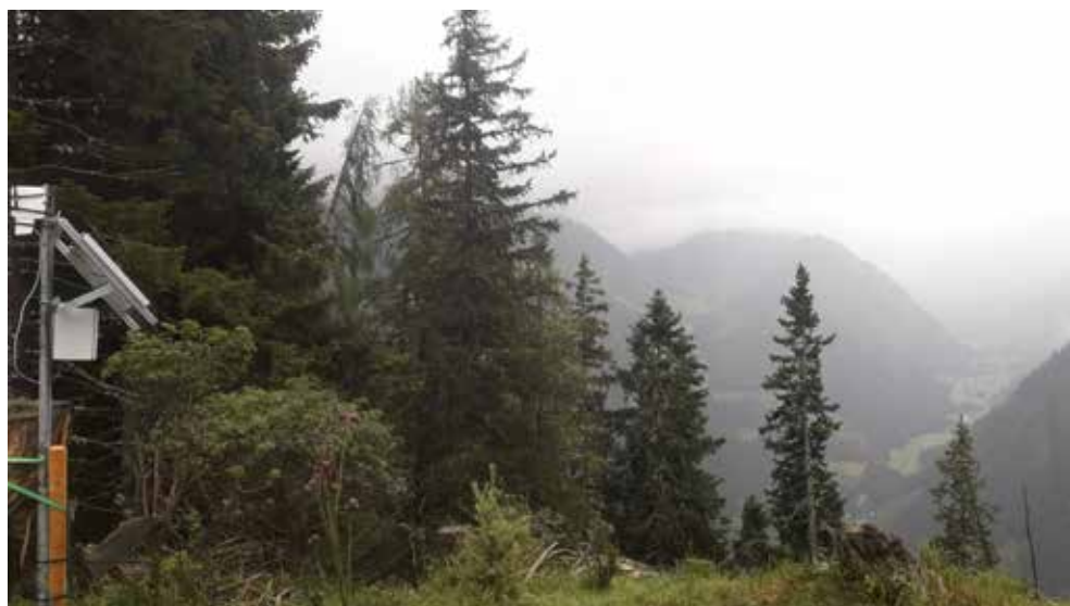
Abbildung 3: Sigfoxantenne mit Blick in die Tuchmoaralm
