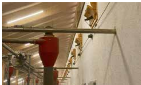
Abbildung 10: Regelbare Abluftklappen im Bewegungsbereich
