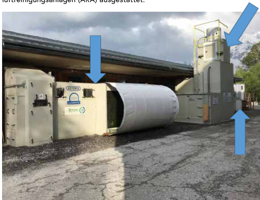
Abbildung 1: Abluftreinigungsanlagen am Schweineforschungsstall der HBLFA Raumberg-Gumpenstein; von links: Fa. Reventa, Fa. Schönhammer, Fa. Hagola
