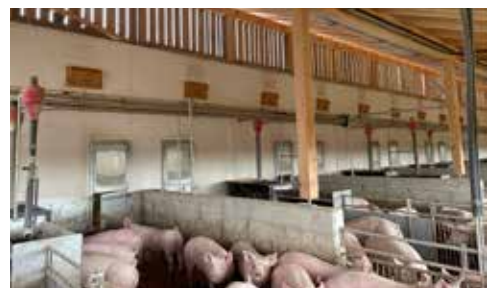
Abbildung 11: Freie Abluftöffnungen am First
