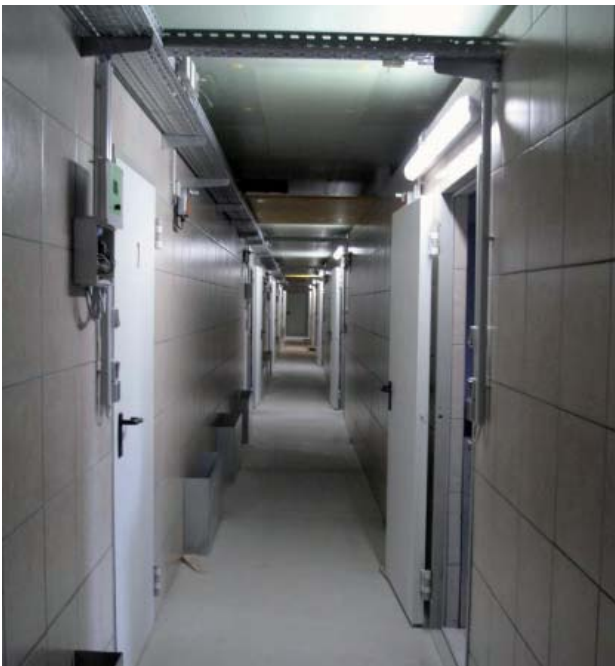
Abbildung 5: Zentralgang in Ferkelaufzucht
