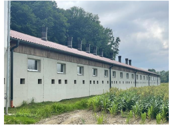
Herkömmliche Belüftung über Seitenwandventile und Abluft über First (Foto: E. Zentner)
