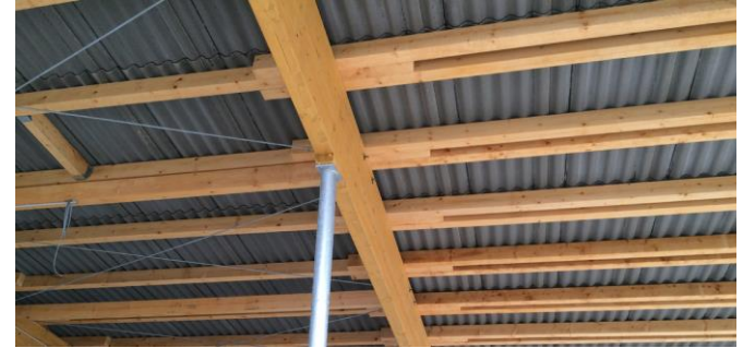
Billige Dachkonstruktionen bringen Probleme im Sommer Foto: E. Zentner
