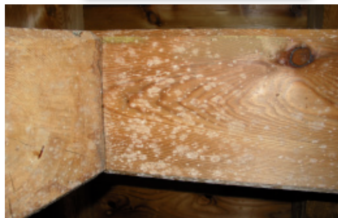
Luftfeuchte über 80 % fördert die Schimmelbildung. Die Erfahrung in der Praxis hat gezeigt, dass der Taupunkt um mindestens 1,5 bis 2 °C unter der Lufttemperatur liegen soll, wobei dieser Wert unbedingt in Kombination zur relativen Luftfeuchte beurteilt werden muss.
