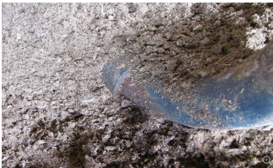
Praxisbetriebe berichten: Feststoffe können Korrosion von Stalleinrichtungsgegenständen beschleunigen. © Albers
