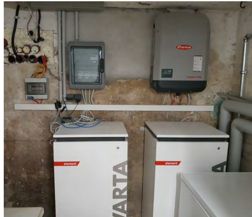
17,6 kWh Li-Ionen Speicher
