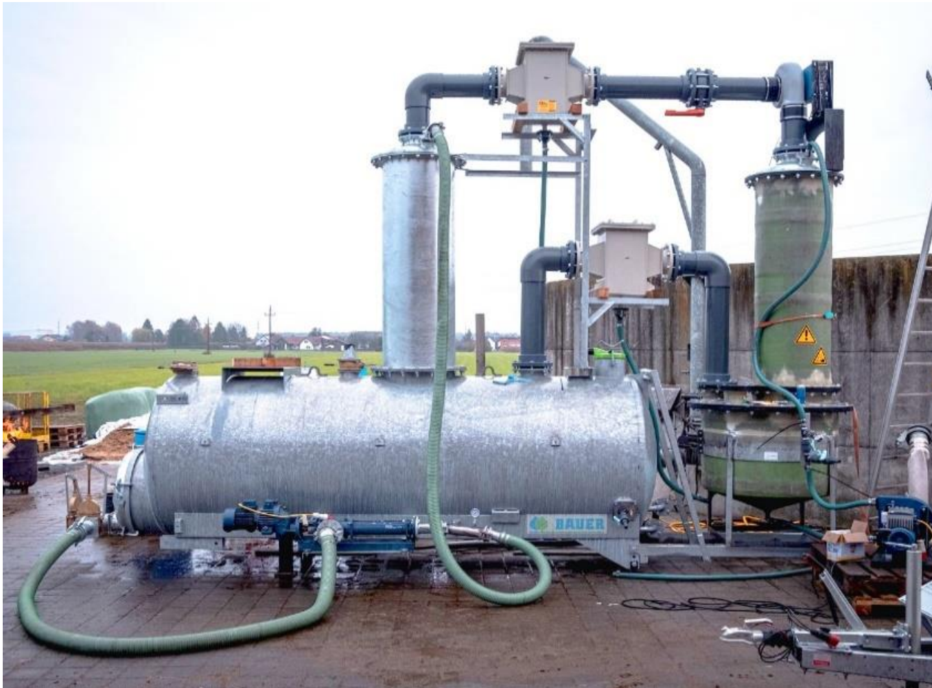
Aufbereitungsanlage: © LK Steiermark, P. Zenger
