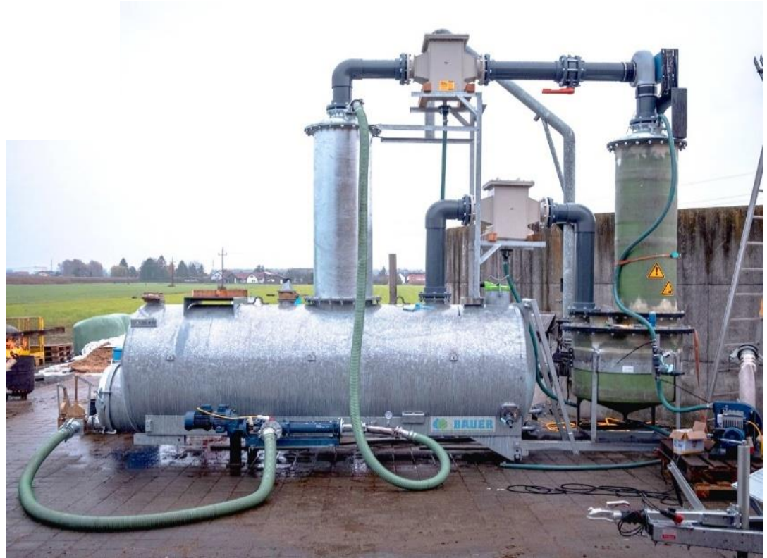
Aufbereitungsanlage: © LK-Steiermark, P. Zenger
