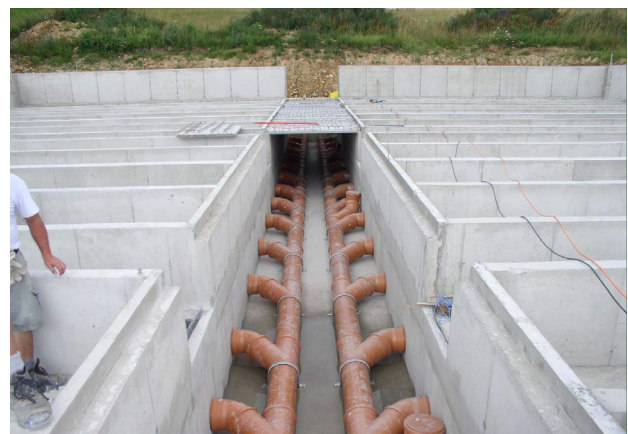
Bild 3: Unterflurzuluftkanal (Quelle: Geißler)
