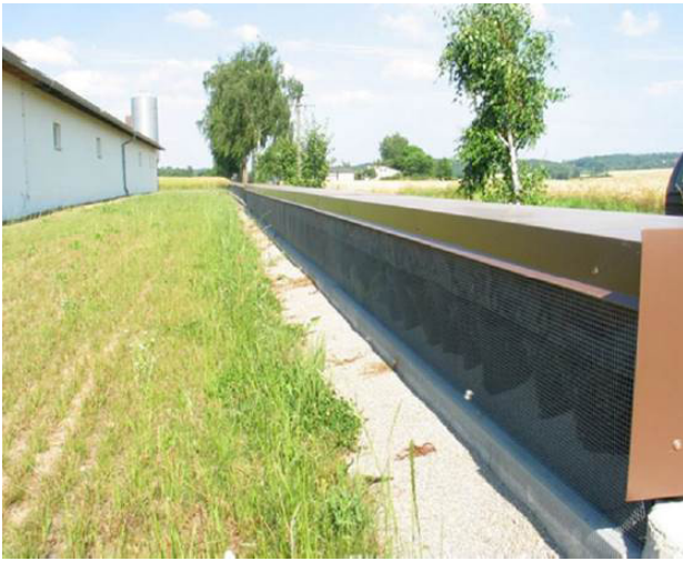
Bild 4: Erdwärmetauscher (Quelle: LSZ Boxberg)
