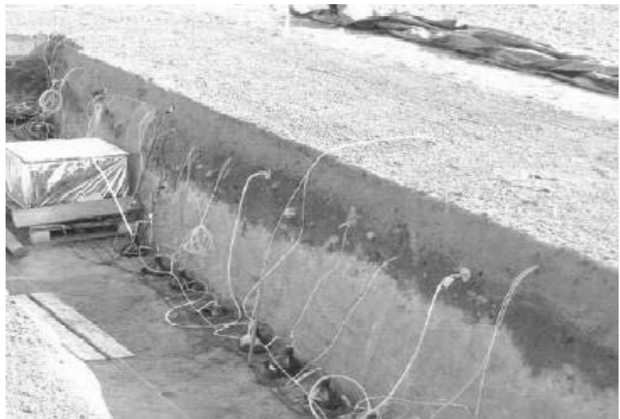
Abbildung 1: Ansicht der Grube mit eingebauten Geräten zur Sickerwasserbeprobung.
