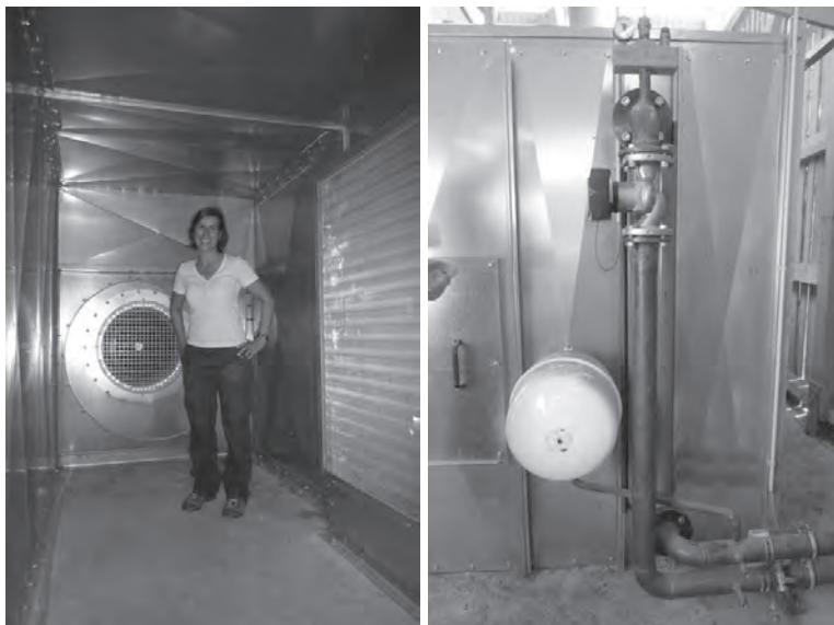
Abbildung 5: Wärmetauscher und Radiallüfter mit KWK-Nutzung
