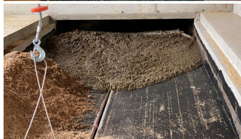
Unterflurschieber u. Harnableitung
