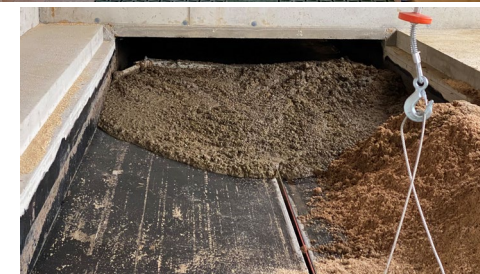
Unterflurschieber u. Harnableitung
