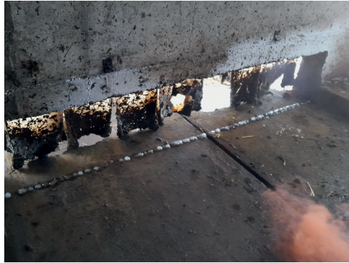
Abbildung 2: Abwurfschacht als Falschlufftquelle
