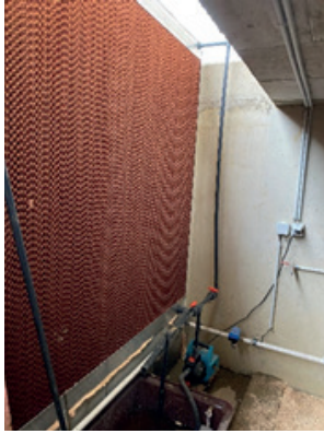
Abbildung 5: Integrierte Coolpads an der Nord- und Südseite des Stalles (Quelle: HBLFA Raumberg-Gumpenstein)
