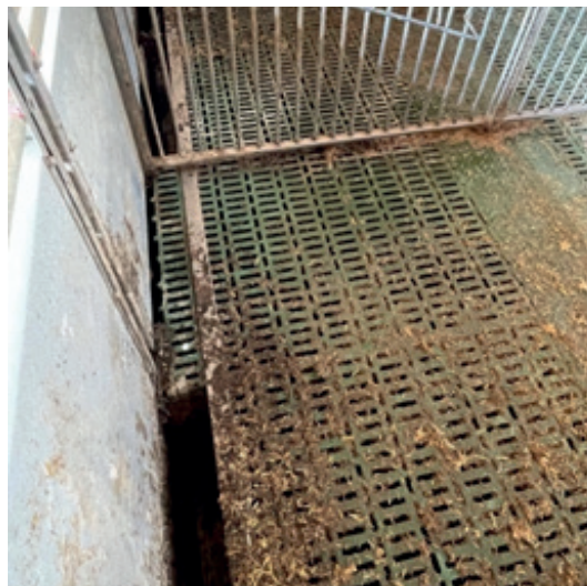
Abbildung 9: Permanenter Verschluss des Kotschlitzes durch 75 cm langes Kunststoffrost-Element im Tränkebereich
