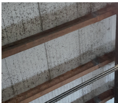
Abbildung 1: Verfärbungen an der Dachunterseite weisen auf fehlerhafte Luftzirkulation hin
