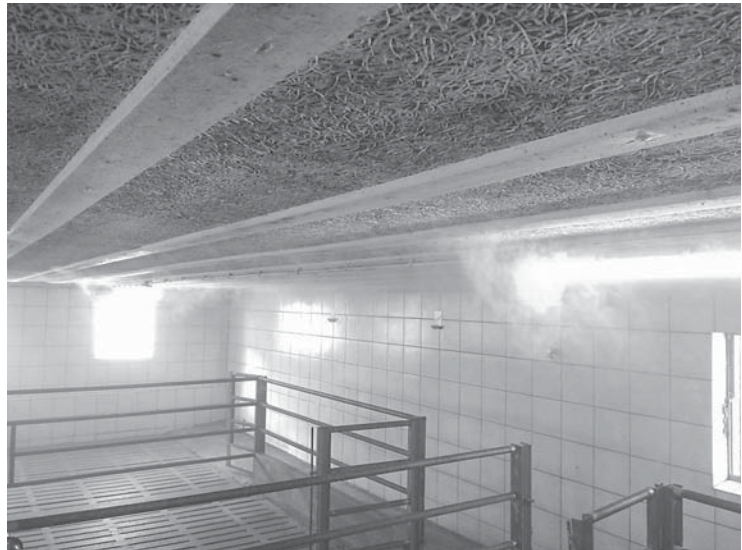
Abbildung 2: Idente Ausführung der Mastphase 2 in allen Abteilen mit Vollspalten und Porenlüftung
