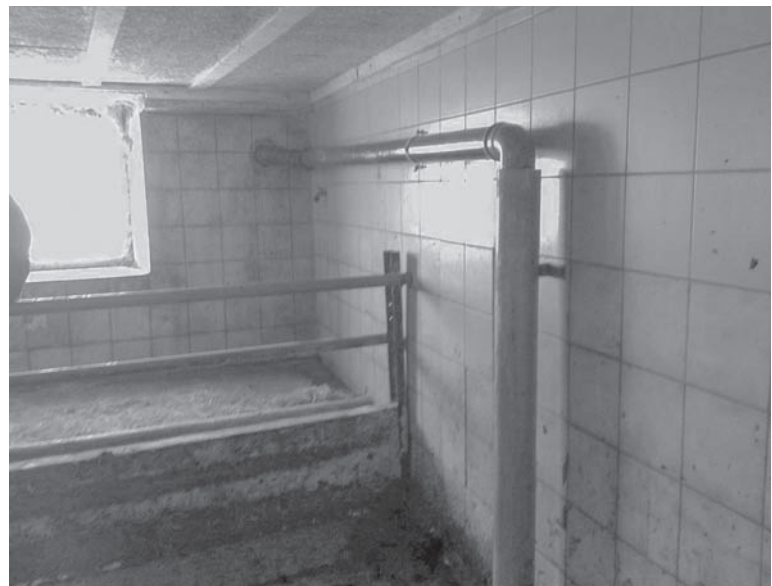
Abbildung 8: Regenwasserleitung in den Güllebereich
