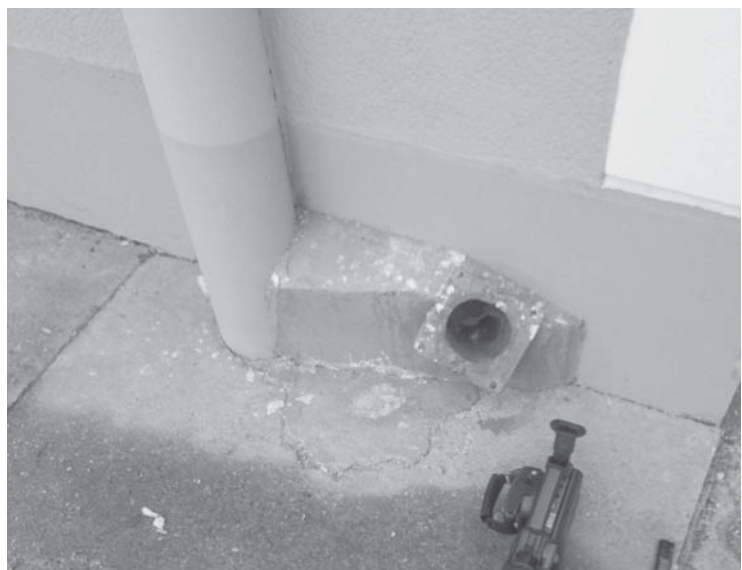
Abbildung 6: Offene Ansaugöffnung an der Außenwand
