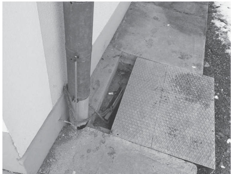
Abbildung 7: Undichter Gülleschieber saugt Frischluft in den Güllebereich
