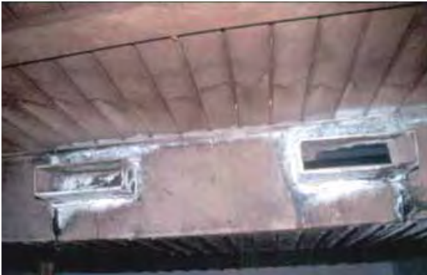
Abbildung 5: Strahl Lüftungskanal mit starkem Kondensat und entfernten Lamellen
