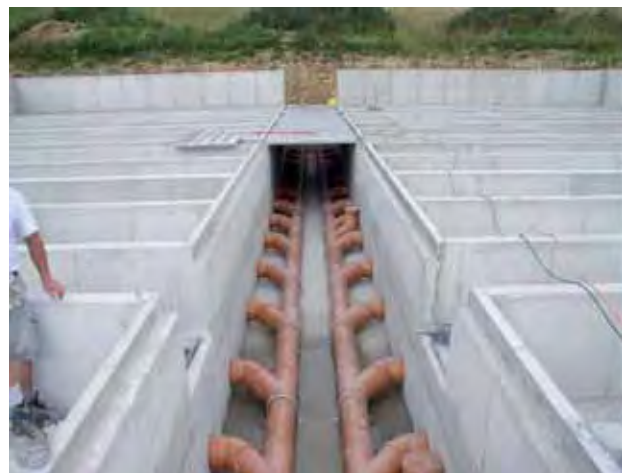
Abbildung 3: Erdwärmetauscher – Unterflurzuluftkanal (Quelle: Geißler, LSZ Boxberg)
