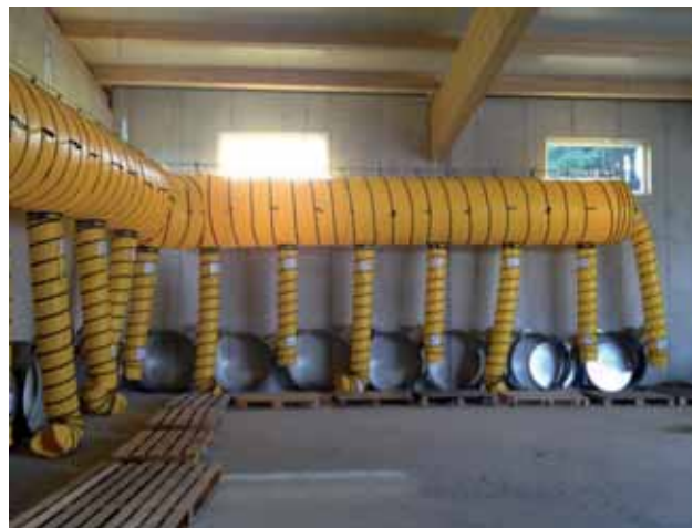
Bild 6: Rundballenbelüftung mit flexiblen Schläuchen (Foto: LASCO)
