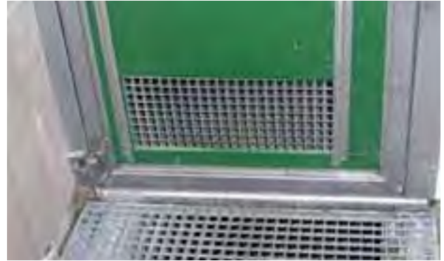
Abbildung 12: Zuluftöffnung in der Abteiltür
