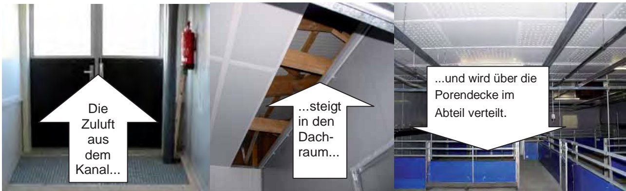
Abbildung 9: Die Zuluft aus dem Kanal steigt in den isolierten Dachraum und gelangt über die Porendecke in den Tierbereich.
