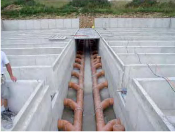
Abbildung 3: Zuluffführung unterhalb des Zentralgangs
