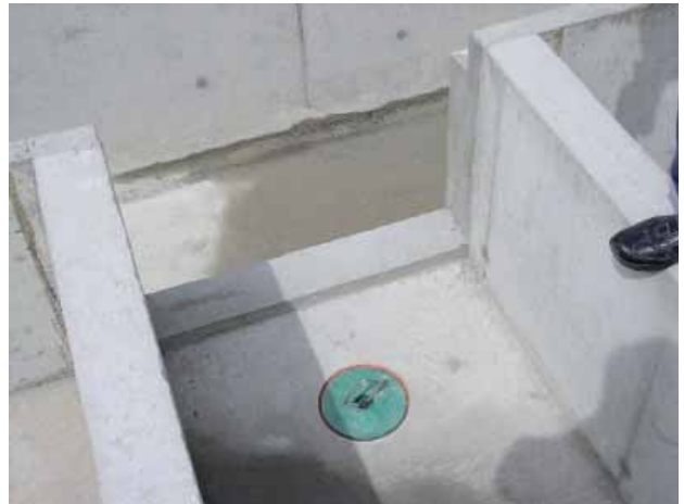
Abbildung 6: Zum Waschen des Zuluffkanals dient die Stau-nase und der Stopfer.
