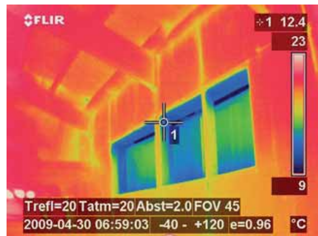
Abbildung 1: Thermografische Aufnahme der Zuluftöffnung
