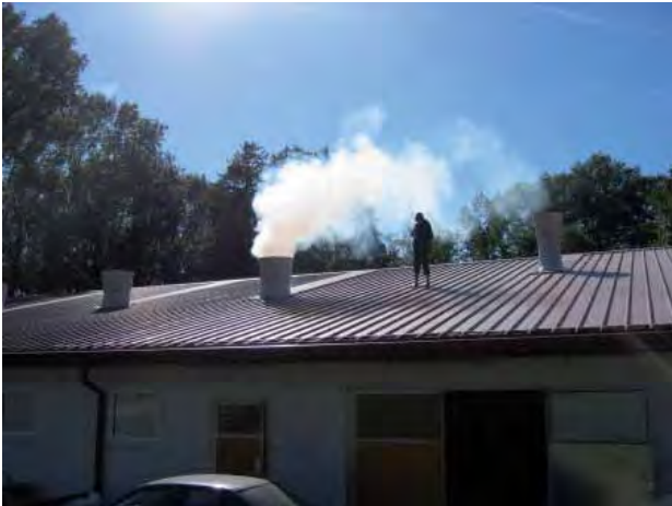
Abbildung 7: Bruch der Abluffahne nach Diffusor
