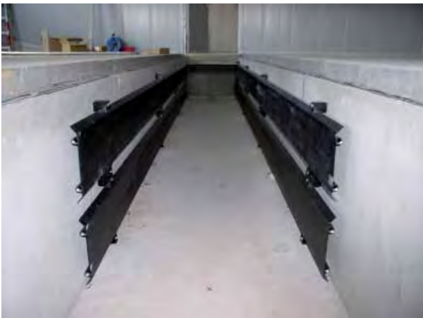
Abbildung 7: Um die Lufttemperatur im Winter über 0°C zu halten, kann durch mit Warmwasser beheizte Wasta-Platten die Zuluff erwärmt werden.
