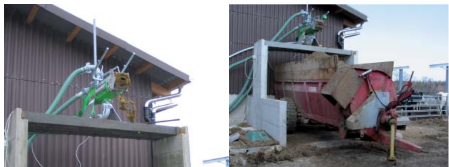
Abbildung 2: Die Rohgülle wird mit einer Siebschnecke (Pressschnecke) separiert (links) und mit einem Kompoststreuer eingestreut (rechts).
