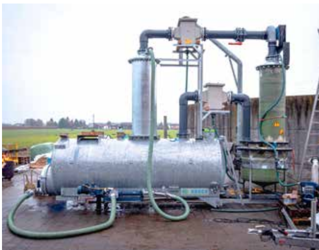
Abbildung 1: Betriebsbereite Aufbereitungsanlage, © LK Steiermark.
