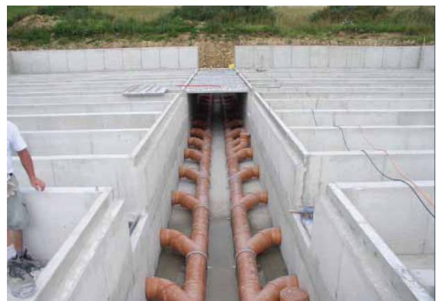
Bild 3: Unterflurzuluftkanal (Quelle: Geißler)
