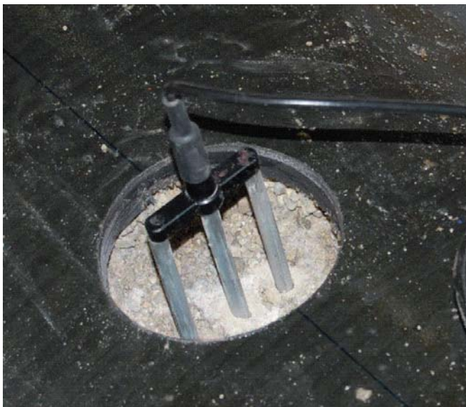
Abbildung 4: Einbau der TDR-Sonden und Tensiometer
