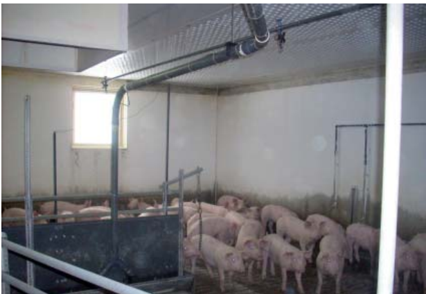
Abbildung 1: Zuluftdecke in einem Mastabteil (gelochte Hartschaumplatte)
