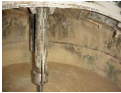
Abbildung 3: Unhygienischer Flüssigfutterbehälter – Biofilm
