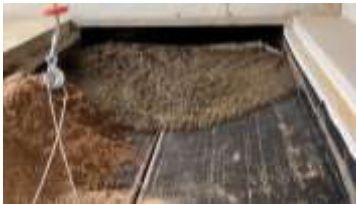
Unterflurschieber u. Harnableitung
