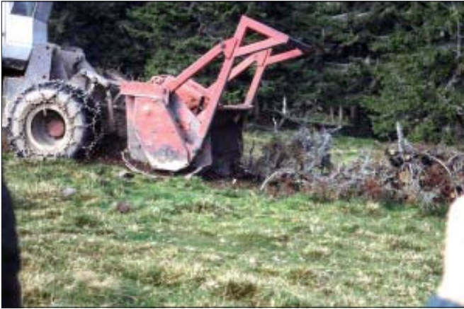
Bild 31: Stockfräse im Einsatz, das Holzmaterial und die Wurzelstöcke werden zerkleinert und in die obere Bodenschicht eingearbeitet
