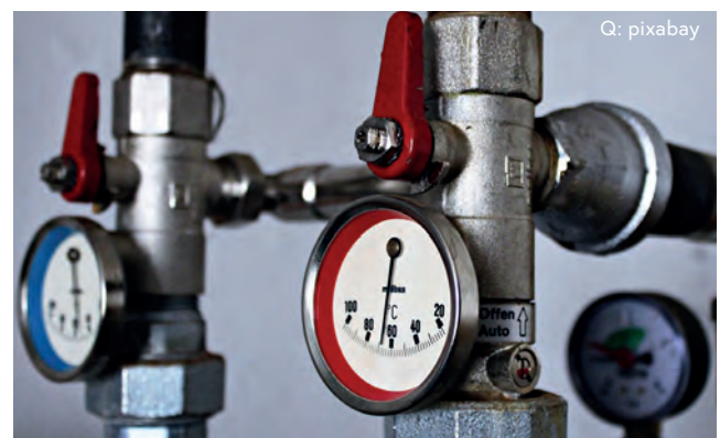
Abbildung 48: Jeder Energieverbrauch sollte hinterfragt und optimiert werden – je nach Anlagengröße auch manuell.
