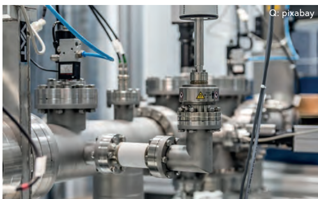
Abbildung 47: Wärmerückgewinnung, moderne Kessel, Gebäudeautomatisierung und Smart Meter können zu energieeffizienten Gebäuden und Anlagen beitragen.
