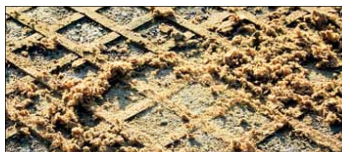
Feuchtigkeit sorgt dafür, dass das Holz aufquillt. Dadurch wird es Stück für Stück aus dem Boden gearbeitet.
