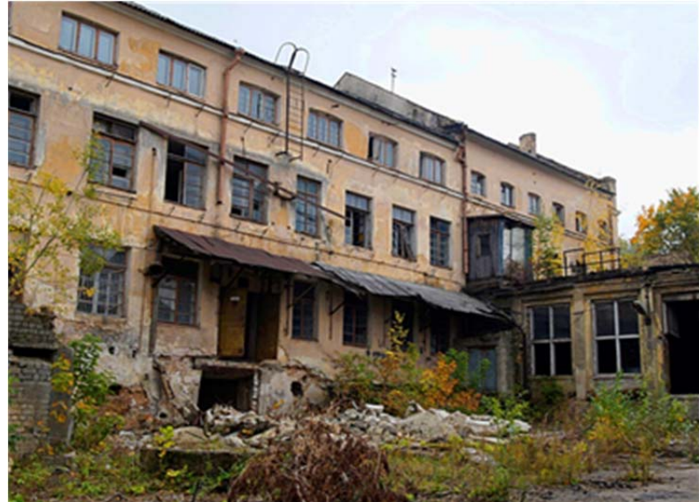
Abbildung 4: Ausschnitt aus der Pilotfläche in Vilnius (Litauen) mit den Resten der Fabrik aus der Sowjet-Ära
