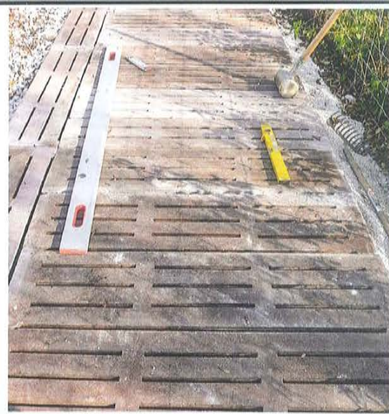
Alte Betonspalten lassen sich begrünen und sind relativ preisgünstig.
