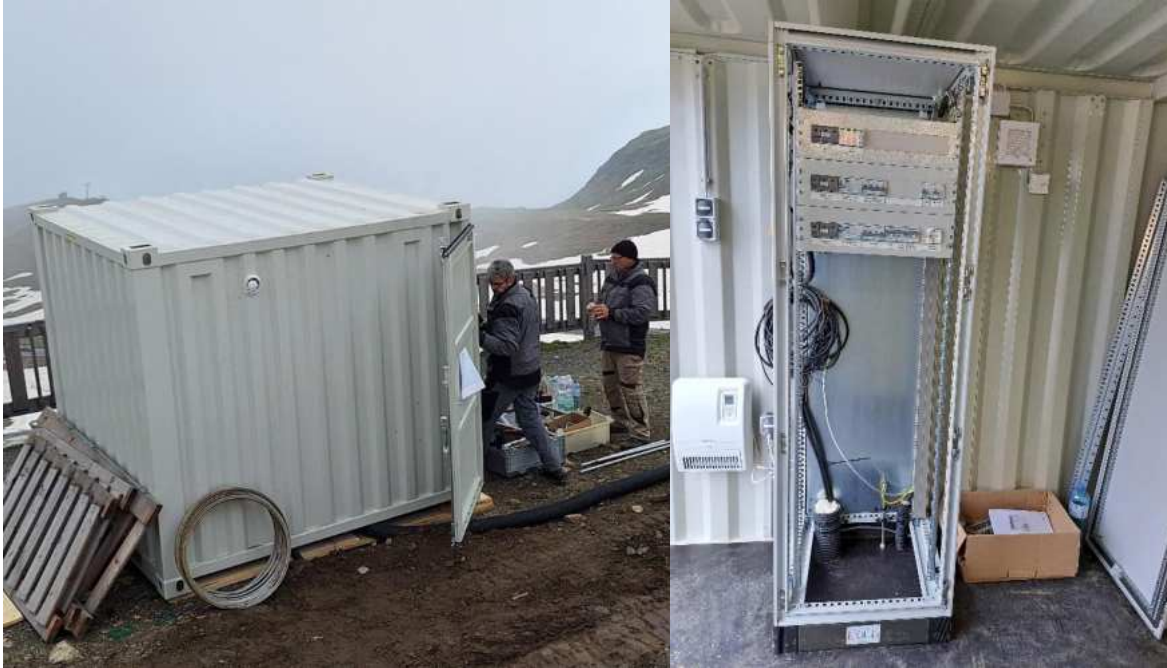
Abbildung 5 Mess- und Steuerungscontainer auf der Versuchsfläche am Hochtor
