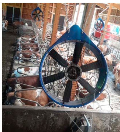
Optimal installierte Ventilatoren sorgen für Kühlung.
