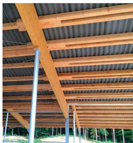
Billige Dachkonstruktionen bringen Probleme für die Tiere.
