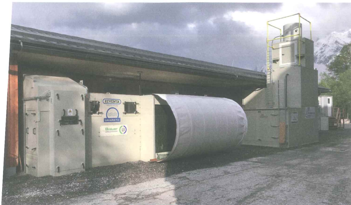
Abluftreinigungsanlagen am Schweineforschungsstall der HBLFA Raumberg-Gumpenstein; von links Fa. Reventa, Fa. Schönhammer, Fa. Hagola
