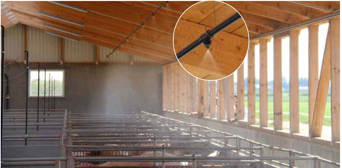
Eine Niederdruck-Vernebelungsanlage ist eine vergleichsweise kostengünstige Methode der Stallklimatisierung. Ein Kühleffekt von bis zu 4 °C ist möglich.
