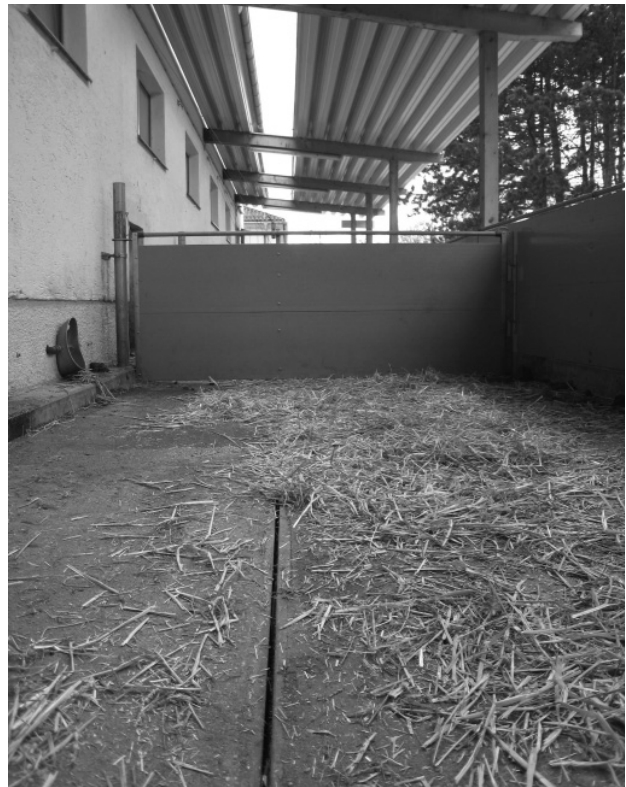
Foto 2: Im Biobereich darf der Auslauf nur teilweise überdacht sein. Eine Abflussrinne sichert trockene Laufflächen.
