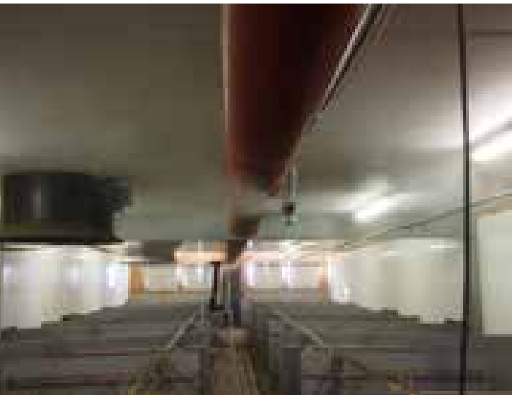
Kühlung der Stallluft durch Zweistoffdüsentchnik
